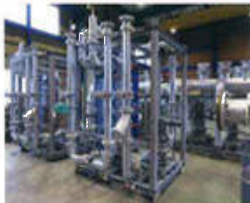
ポンプユニット
