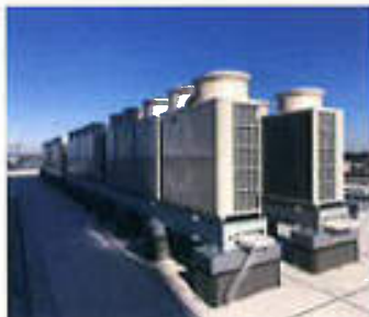
室外機ユニット
